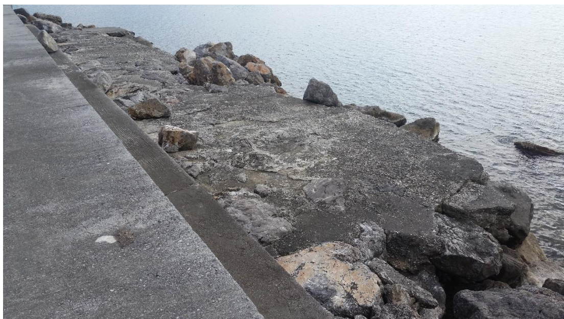
Φωτ.3: Θωράκιση προσήνεμου μώλου επικαλυμμένη με πλάκα σκυροδέματος, επί της οποίας εδράζεται τοίχιο
